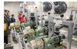
大きなポンプが何台も三崎公園の下から、海水をくみ上げる過して使用
